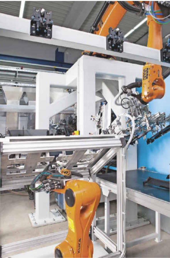
Die Arbeitsteilung der Kuka-Roboter in der kompakten Spritzgießzelle: Der Konsolroboter KR60 handhabt von oben die großen, spritzgeossenen Motorraum-Abdeckungen (hier nicht zu sehen), während der kleine, flinke Sechschachser KR10 von unten die Prüfungen mit Kamera vornimmt und mit Greiferzange die Clips montiert. Bild: Kuka
